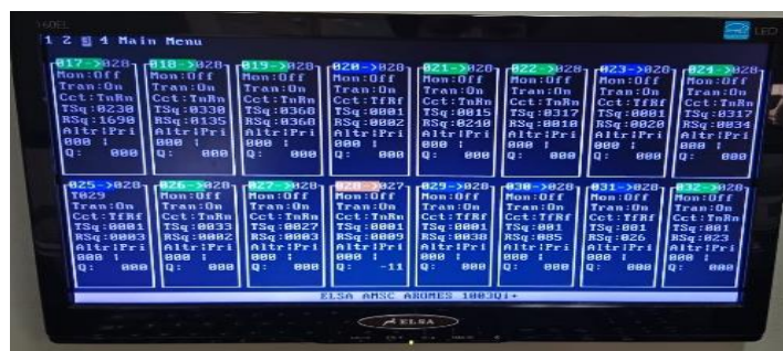
Gambar 12 Alarm Pada Chanel 28
