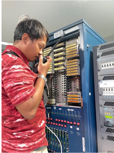
Gambar 8. Pengecekan audio pada IDF VSCS
